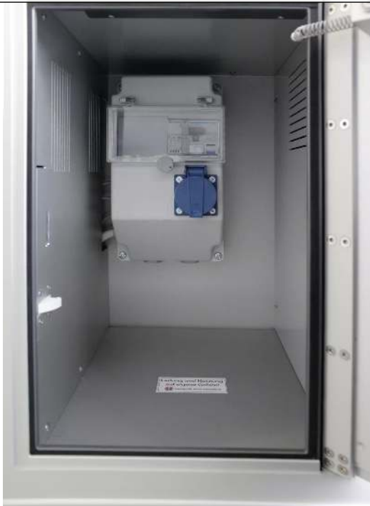
Innenansicht Schließfach mit Elektroinstallation
