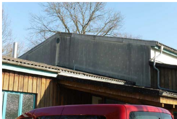
WDVS ggf. durchfeuchtet, Wärmebrücken an Dübeln - prüfen und ggf. sanieren
