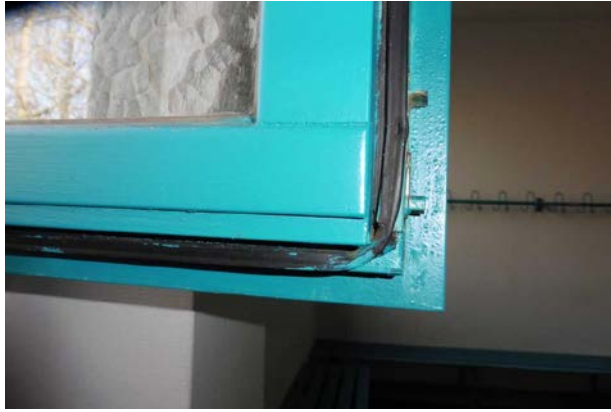
Fenster- und Türdichtungen verbraucht - erneuern, einstellen
