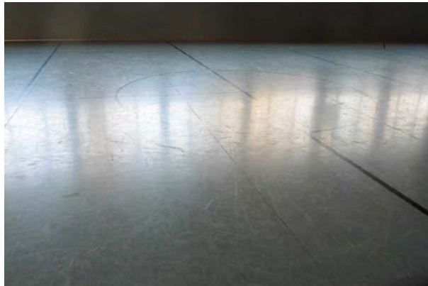
Boden "eingebrochen", Dämmung nass und beschädigt - reparieren, austauschen, erneuern
