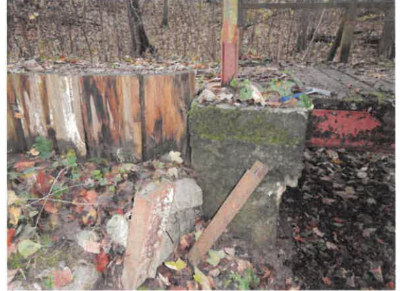
VERSAGENDE BÖSCHUNGSSICHERUNG IM FLÜGELBEREICH
