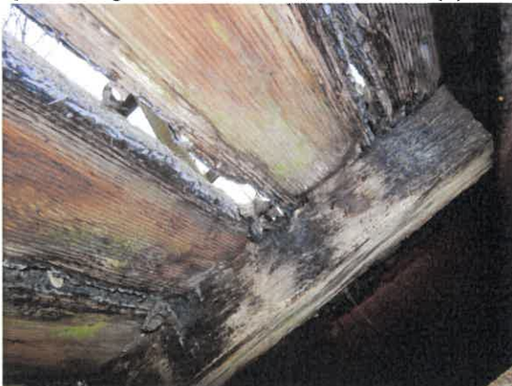
BOHLEN UNTERSEITE STARKER PILZBEFALL
