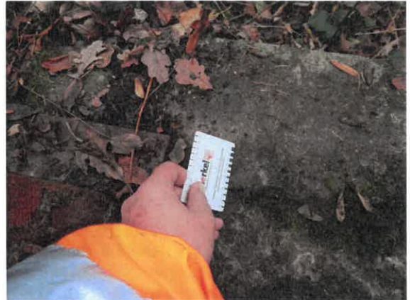
OBERSEITE BETON WIDERLAGER RIß ÜBER MONTAGEÖFFNUNG LÄNGSTRÄGER
