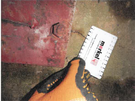
WIDERLAGER HINTEN BETON HORIZONTALRISSE
