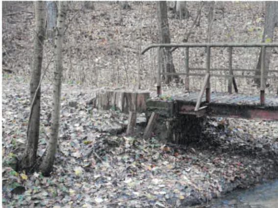
WIDERLAGER VORN LINKS UND HINTEN LINKS UND RECHTS SIND OHNE FLÜGEL
