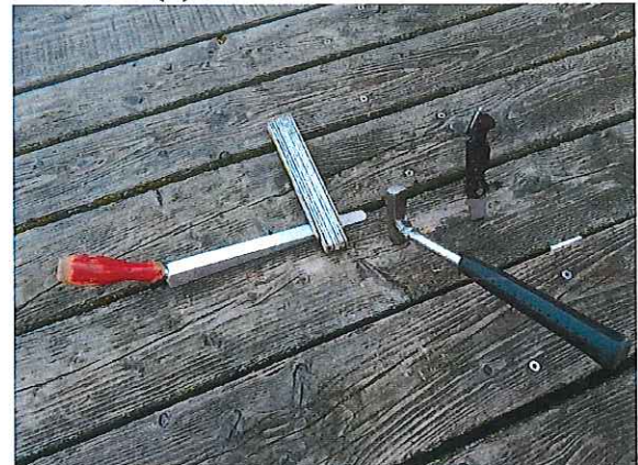
KLWI901_A_2019H_BELAG F-17 HINTEN MITTIG BOHLE ABGESACKT
