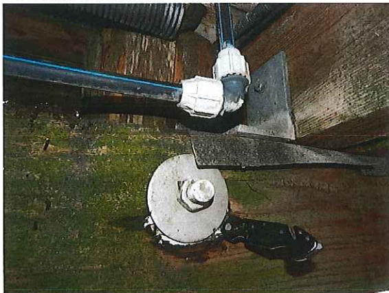
KLWI901_A_2019H_QT-14 VORNE AN VERSCHRAUBUNG VERFAULT
