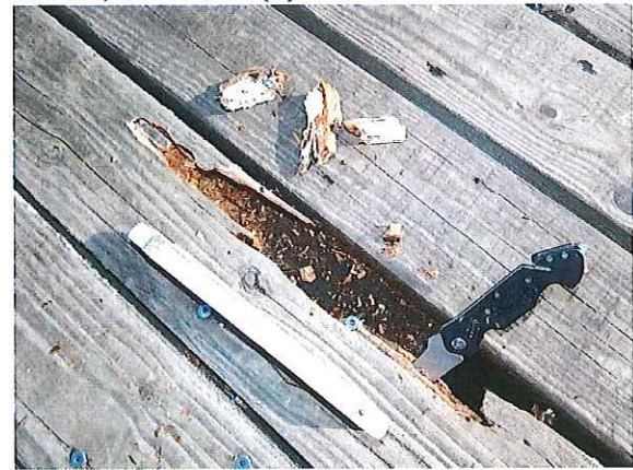
KLWI901_A_2019H_BELAG F-9 VORNE MITTIG BOHLE DURCHGEFAULT
