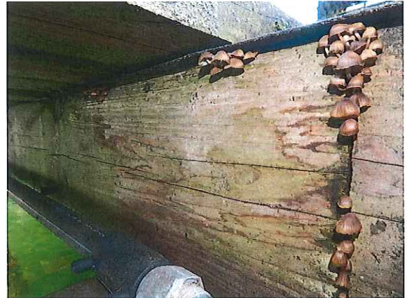
KLWI901_A_2019H_LT-3 A-18 RECHTS PILZBEWUCHS
