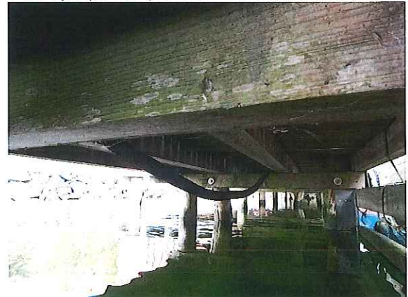
KLWI901_A_2019H_SCHUTZROHR F-9 DURCHHÄNGEND
