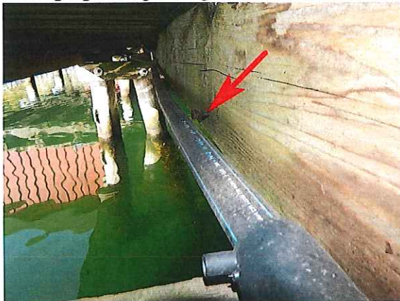
KLWI901_A_2019H_LEITUNG F-17 HINTEN SCHELLE DURCHGEROSTET
