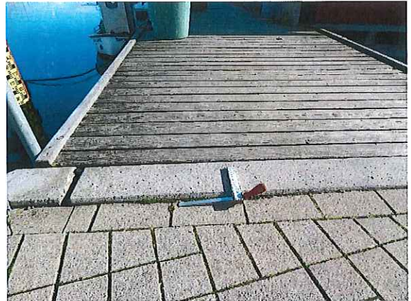
KLWI901_A_2019H_PFLASTER VORNE ABGESACKT
