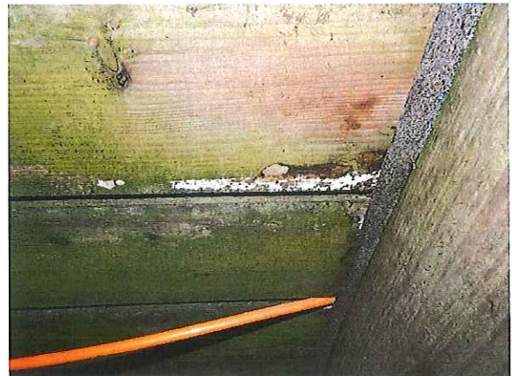
KLWI901_A_2019H_BELAG F-1 MITTE MITTIG UNTEN PILZBEFALL
