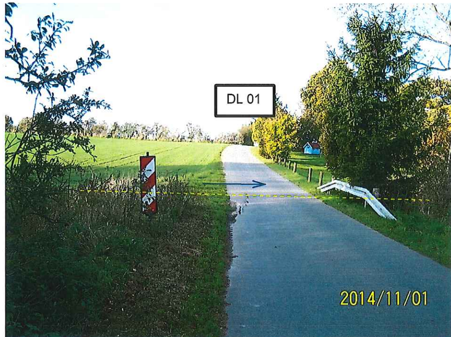
Fahrbahnbelag aus Asphalt, Warnbake falsch angeordnet, Schrägstriche müssen zur Fahrbahn zeigen
