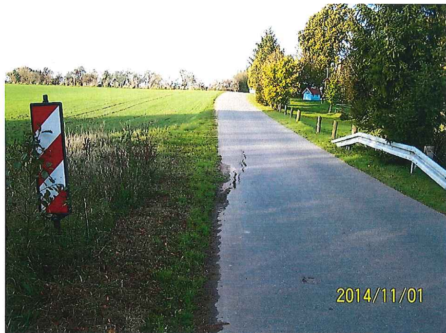
Fahrbahn gebrochen, rutscht in Richtung Einlauf
